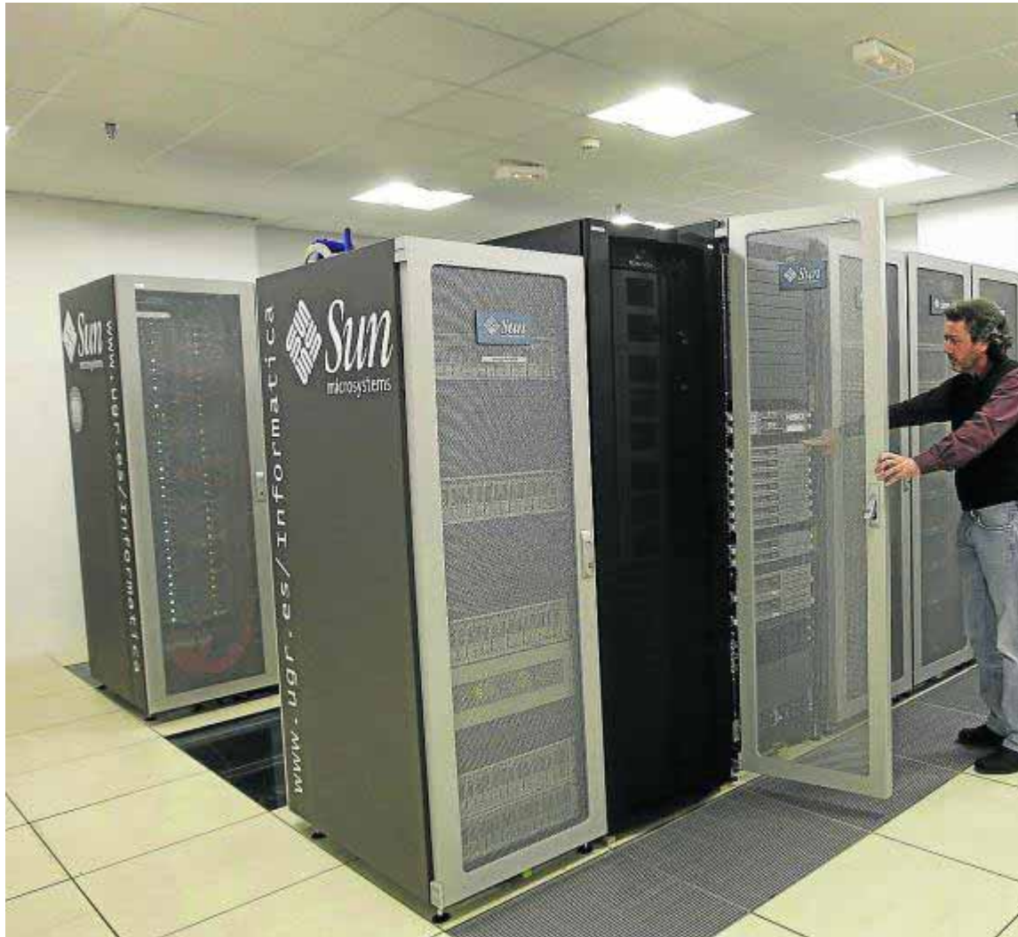
Supercomputador utilizado en el Edificio Mecenaz de la Universidad de Granada. :: GONZÁLEZ MOLERO
