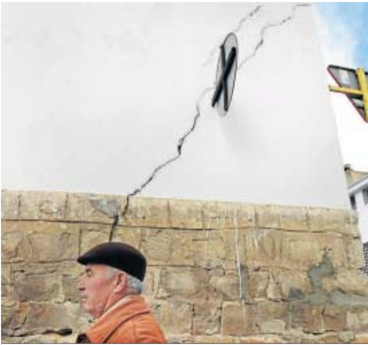
La grieta que atraviesa la fachada del colegio de Primaria del pueblo.
